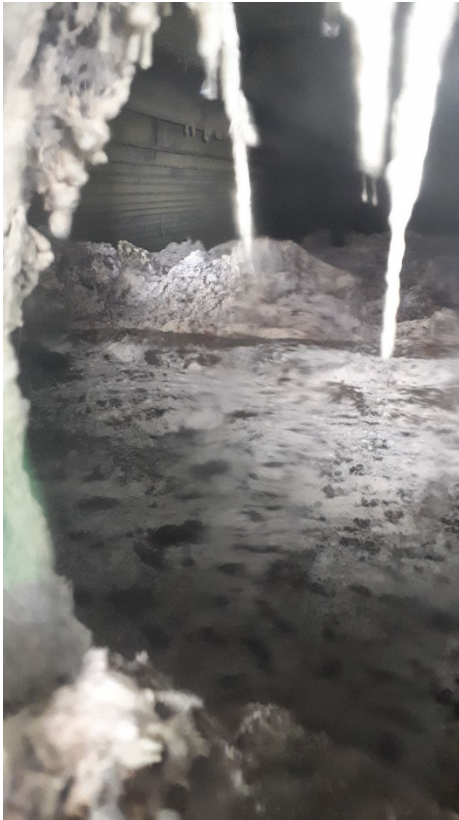
Abbildung 4: Foto der Schwimmschicht in der Praxisanlage
